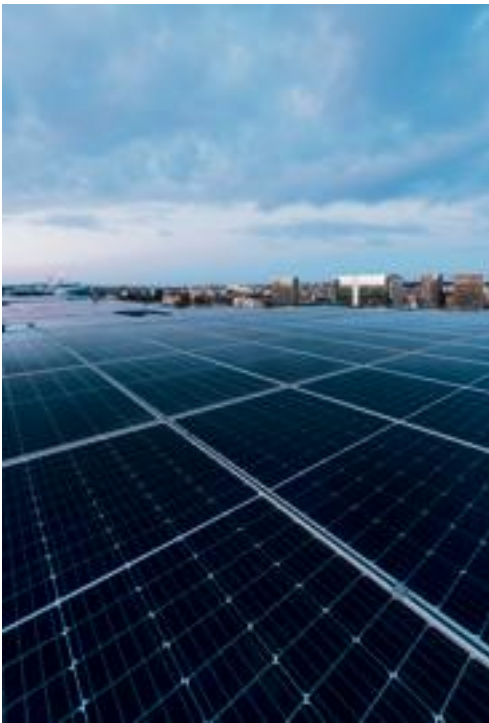
771 panneaux solaires recouvrent le dernier étage de l'immeuble.
