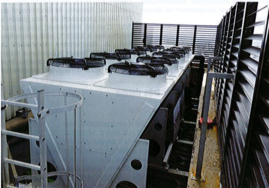
Il a fallu trouver 54 m² pour les aéroréfrigérants secs au lieu de 15 m² seulement pour les tours. Trois niveaux de terrasse ont été créés à l'aide de structures métalliques.
