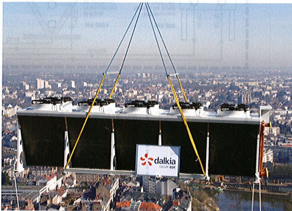
Deux dry-coolers d'une puissance de 1 MW et d'un poids de 3 tonnes ont été hélicoptérés et remplacent les tours aéroréfrigérantes. Les régimes de températures ont été modifiés côté condensation dans la nouvelle installation.
